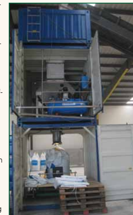
Doorkijkje in de installatie
